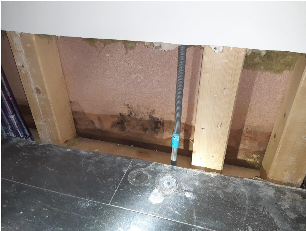
Abbildung 15: Geöffnete durchfeuchtete Holzrahmenwand (Estrich und Fliesenboden noch vorhanden)
