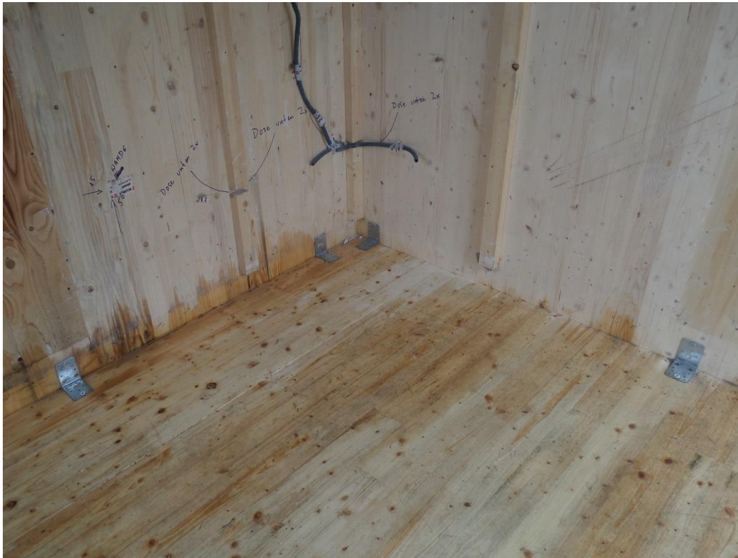
Abbildung 14: Durchfeuchtete Decken- und Wandkonstruktionen aus Brettsperrholzplatten
